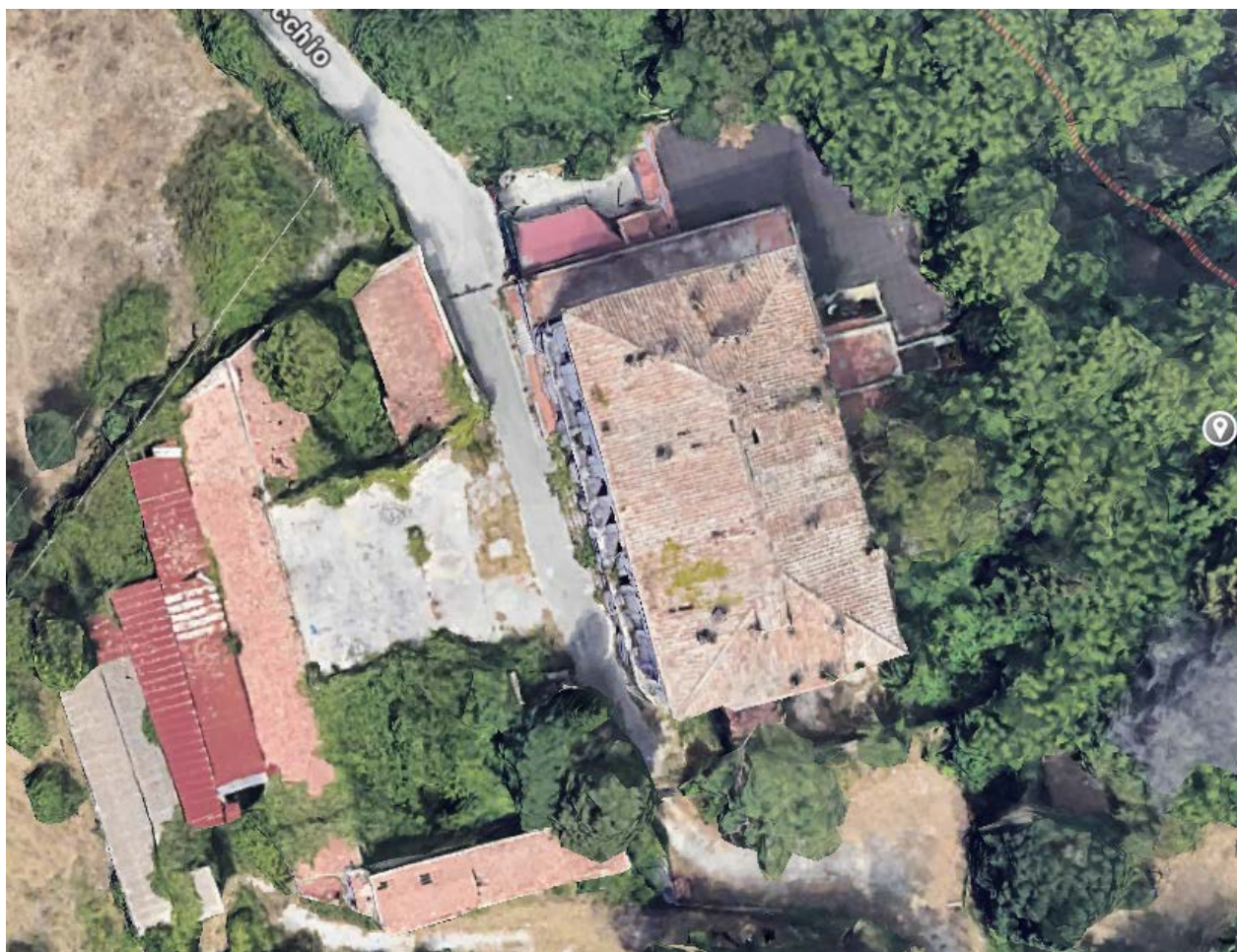
Figura 4. Veduta aerea zenitale del real "Antico casino di San Leucio" in Vaccheria, la cui copertura mostra cedimenti (da www.maps.google.com ).
