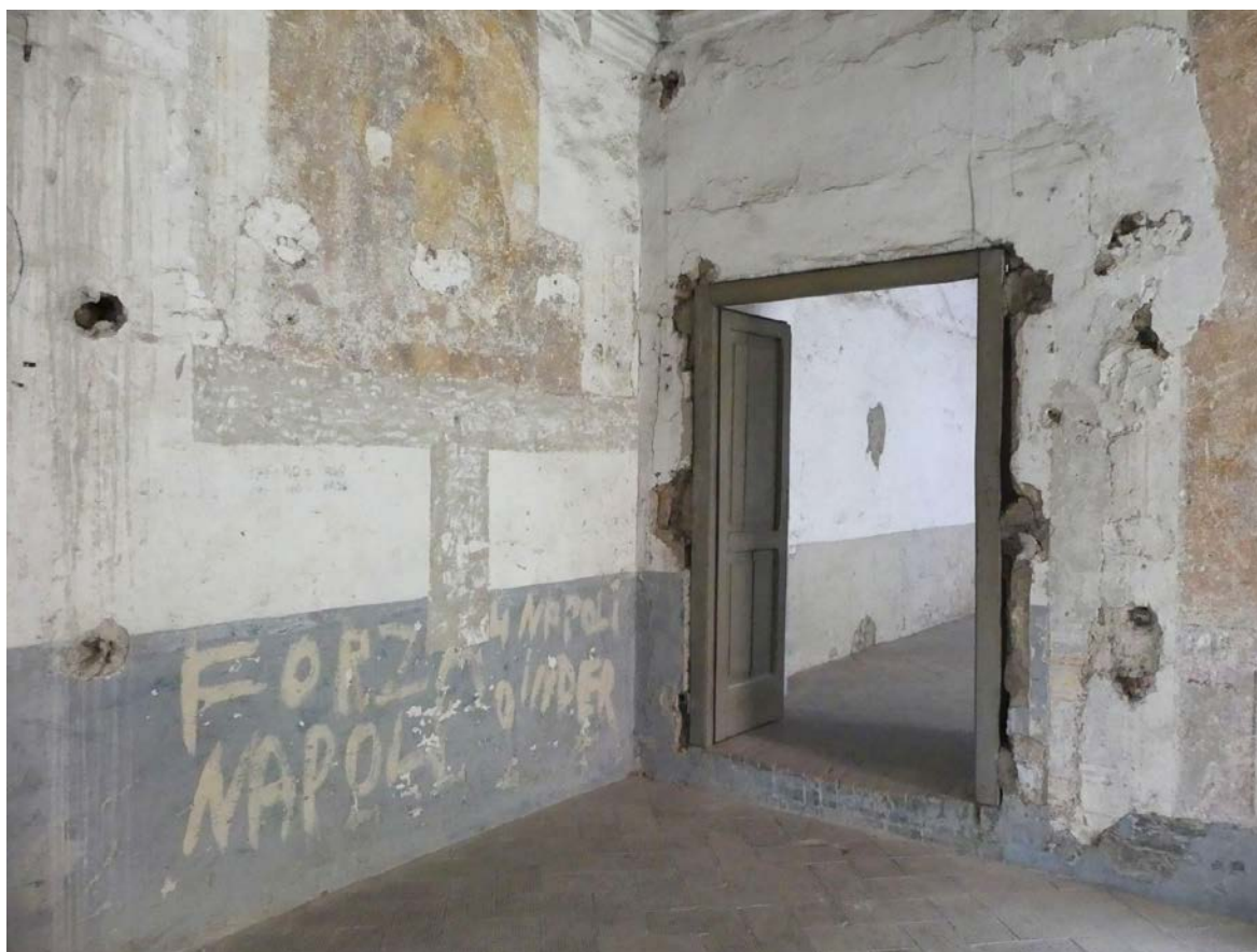
Figura 2. Caserta, Palazzo al Boschetto. Sala di Giuditta e David. Scritta vandalica «FORZA NAPOLI».
