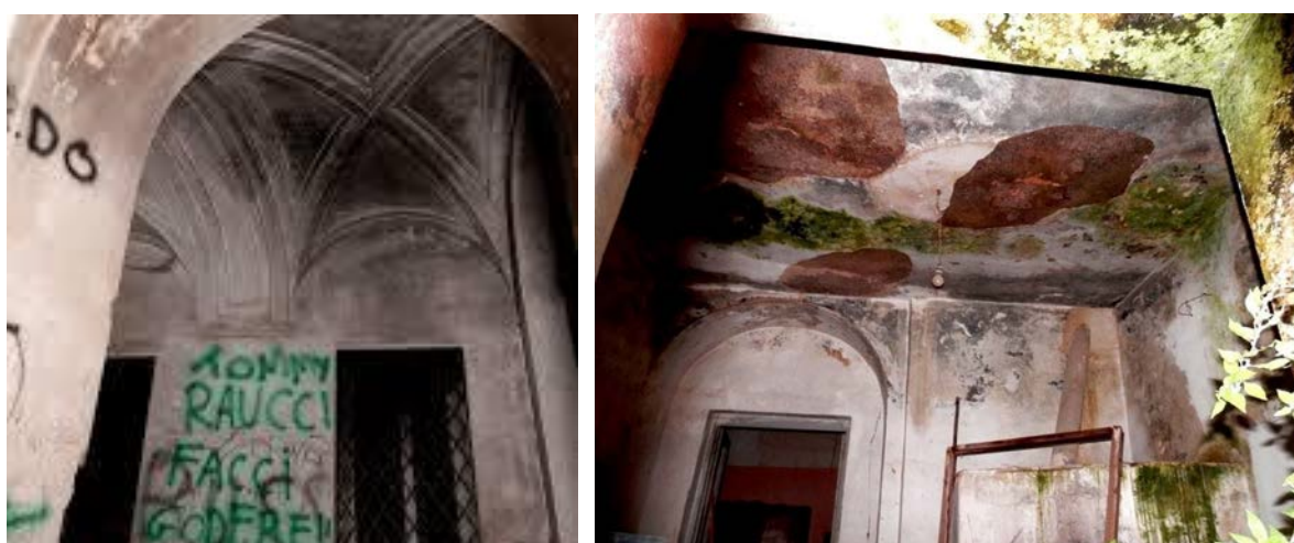
Figura 3. Particolari delle vandalizzazioni e del degrado architettonico del real "Antico casino di San Leucio" in Vaccheria.
